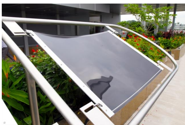
左：PSA の新パシール・パンジャン第 3 ターミナルビル（シンガポール）に設置されたソーラーフロンティアのベンダブル CIS 薄膜太陽電池モジュール
